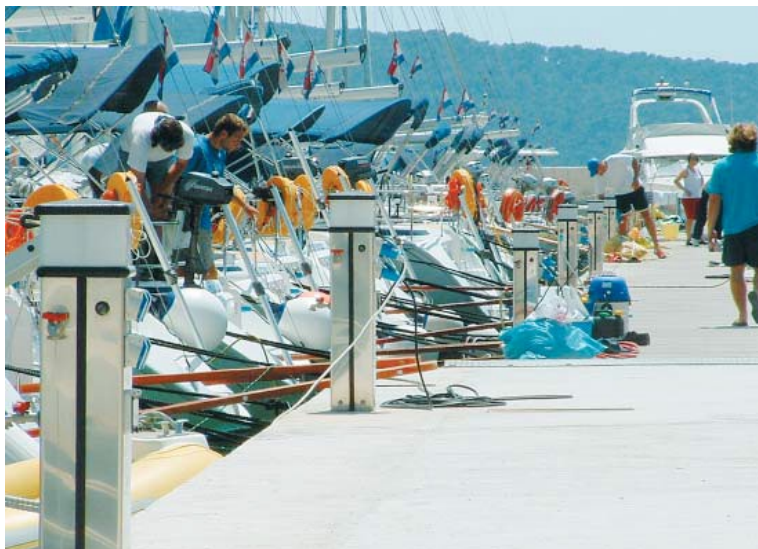
Фигура 29: Колонки за електро захранване и водоснабдяване
